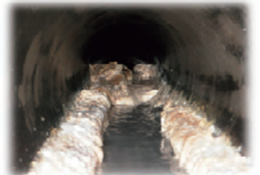
▲下水道管内に付着した油
