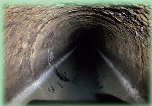
▲老朽化が進行した管の内面 (鉄筋コンクリート管 内径1100mm)
