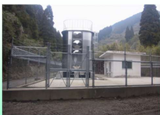
松梅北部浄水池
