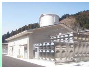
富士中央水道施設棟
