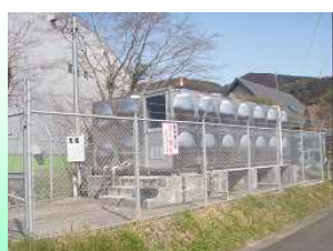
富士南部水道施設第二配水池
